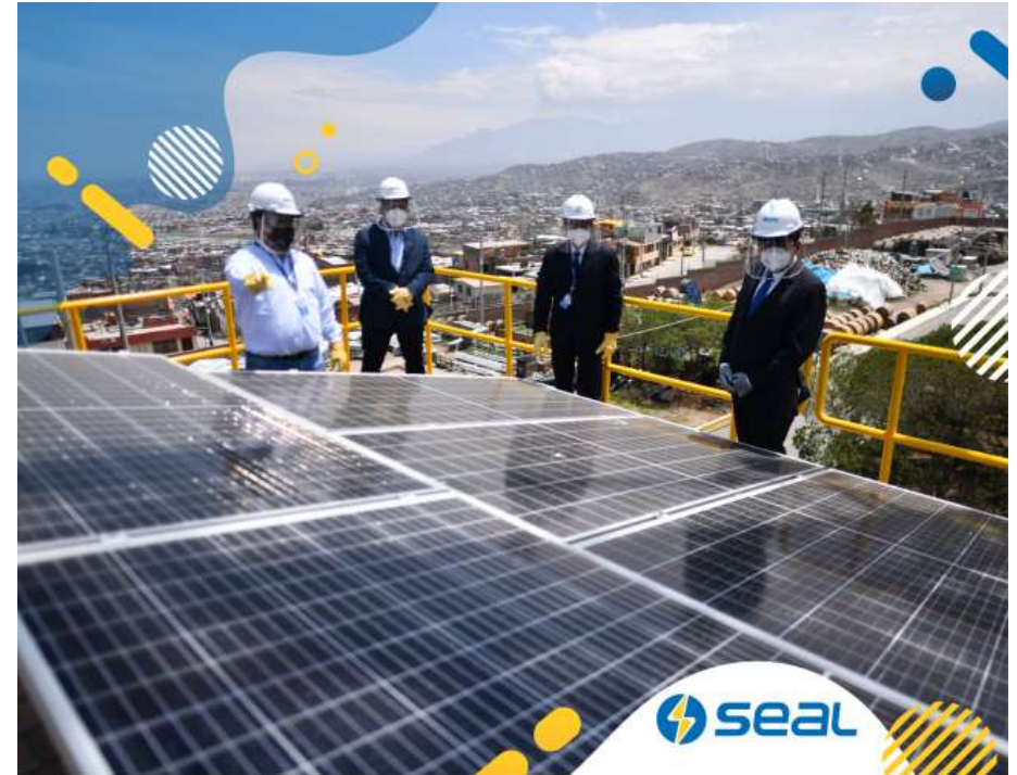
Implementación de Paneles Solares en la Sede de Parque Industrial.
