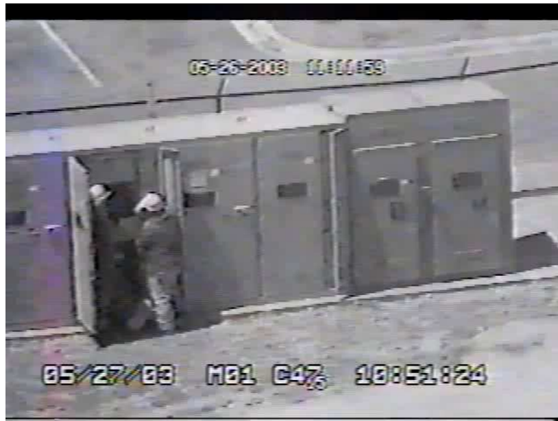
ARCO ELÉCTRICO EN BT
