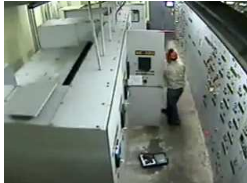
ARCO ELÉCTRICO EN MT
