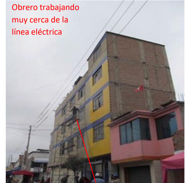
Obreros trabajando muy cerca de la línea eléctrica
